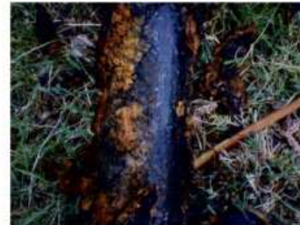
7. kép korrodált cső
