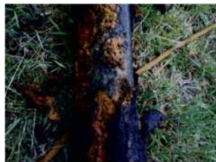
6. kép korrodált cső
